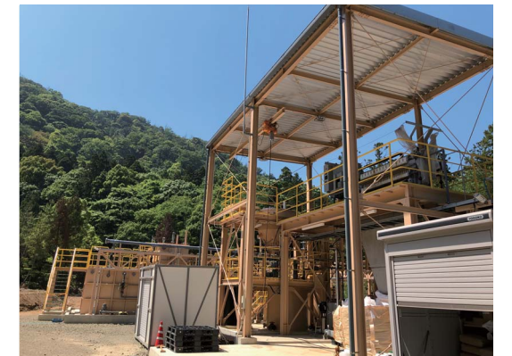
新たに稼働した酸性水の処理設備（鶴峰鉱山）
